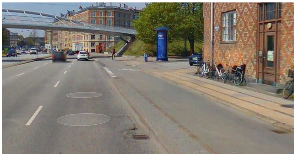
Figur 6 Chausse-belagt areal på den yderste del af cykelstien frem mod Hans Egedes Gade
