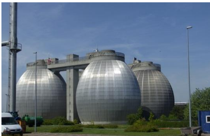
Figur 3. Biogastankanlæg på Avedøre Spildevandscenter ejet af ”Vores Rens A/S”. Tankanlægget forgasser spildevandsslam, men har overkapacitet, så den ene tank kan ombygges til forgasning af affald. Kilde: Avedøre Spildevandscenter/ Vores Rens A/S
