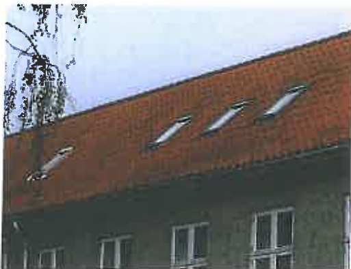
Jeppes Allé 2 Forskellige tagvinduer mod gade
