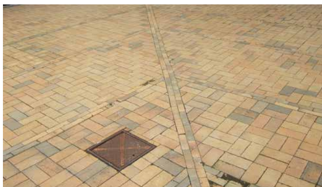
Sammenskæring og vandrende i teglbelægninger.
