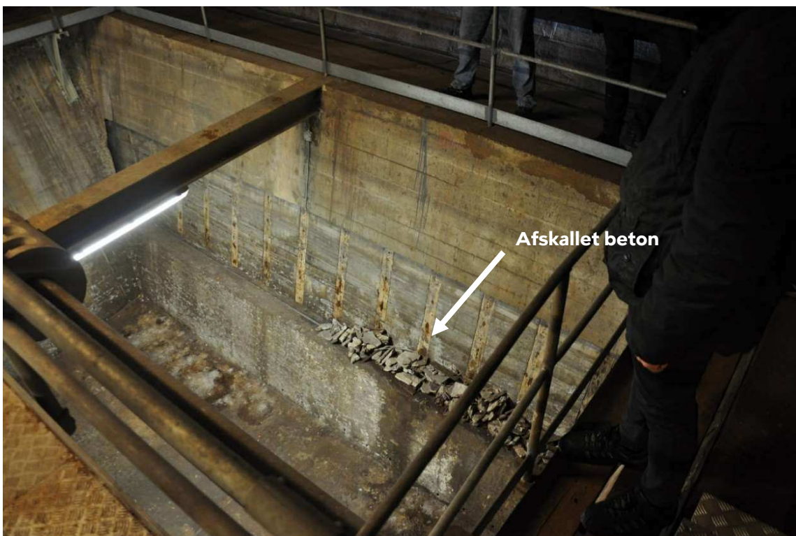
Afskallet beton fra kontravægten
