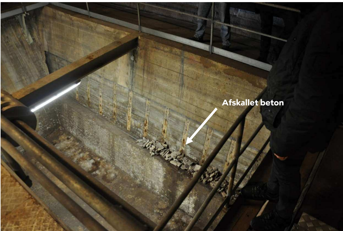
Afskallet beton fra kontravægten
