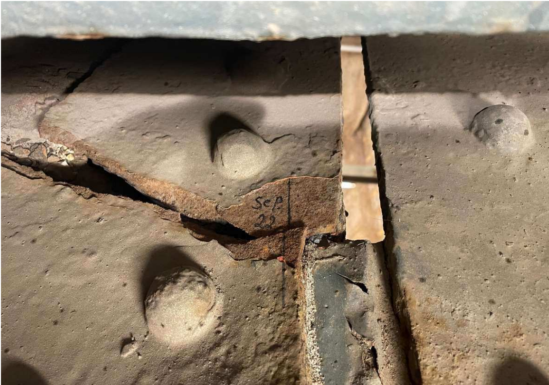
Stålbeklag på hjørnet af den faste kontravægt revnet/revet over pga. volumenudvidelse af ballastbetonen med indstøbt stålskrot. Skaden udvikles fortsat.
