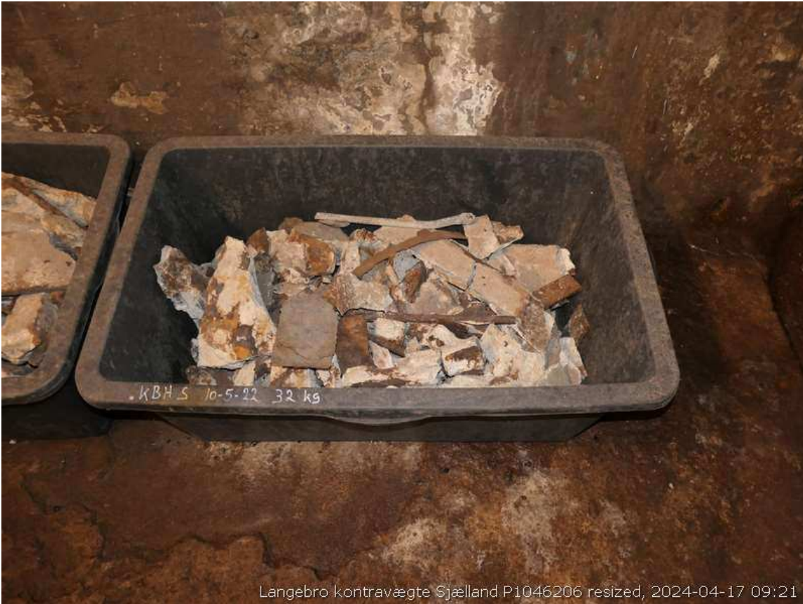
Afskallet beton fra kontravægten opsamlet i spande
