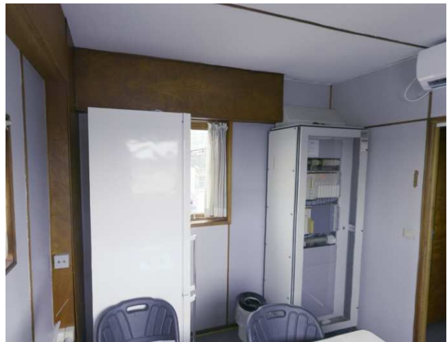
Figur 26: Eksisterende installationsskab i "PLC-rummet" to etager under kommandobroen. Fjernes da dette ikke skal bruges længere. Eksisterende kabelkanaler i mahogni vil blive brugt til føring af nye kabler.
