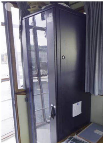
Figur 25 Eksisterende installationsskab til Lille Langebros styring. Flyttes ned i nyt tavlerum i buefag Sjælland.
