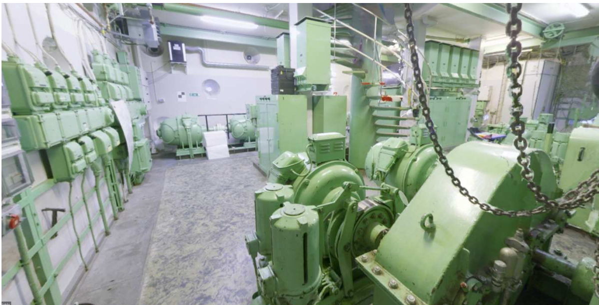
Figur 18: Overblikbillede over maskinrum Sjælland nord set fra sydvest. Alt maskineri og installationer der ses på billedet, bliver inaktivt, men bevares da det ikke er i vejen. I gulvet langs væggen til venstre ses låg over en kabelkanal. De kabler der ses ført ned i kanalen, overskæres under låget, og alle kabler i kanalen fjernes for at skabe plads til de nye installationer og sikre mod fejlagtig kobling af spænding til efterladt udstyr.
