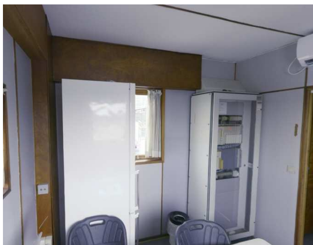
Figur 26: Eksisterende installationskab i "PLC-rummet" to etager under kommandobroen. Fjernes da dette ikke skal bruges længere. Eksisterende kabelkanaler i mahogni vil blive brugt til føring af nye kabler.
