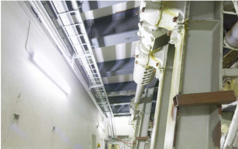
Figur 23: Kabelbakker/stiger - her i klapkælder Sjælland. Eksempel på elinstallationer der er kommet til i tiden efter broens indvielse, og som fjernes.
