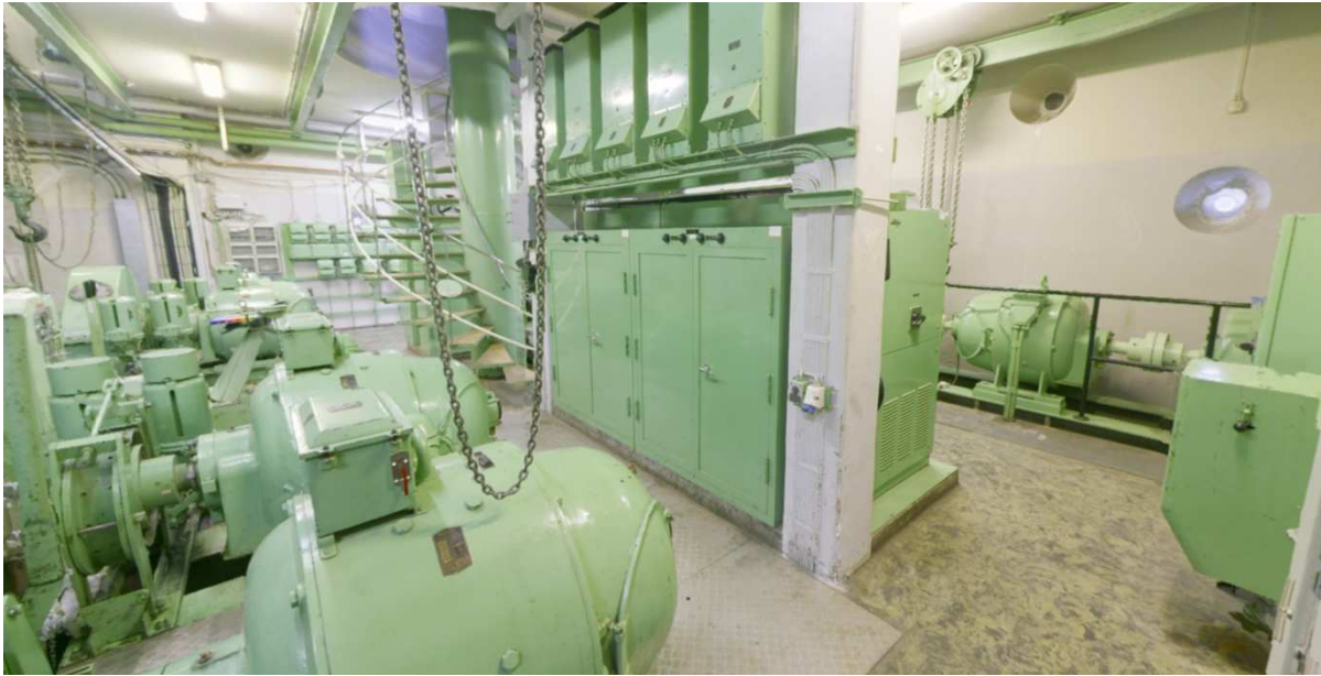
Figur 17: Overblikbillede over maskinrum Sjælland nord set fra øst. Alt maskineri og installationer der ses på billedet, bliver inaktivt, men bevares da det ikke er i vejen.
