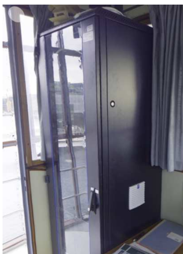
Figur 25 Eksisterende installationskab til Lille Langebros styring. Flyttes ned i nyt tavlerum i buefag Sjælland.
