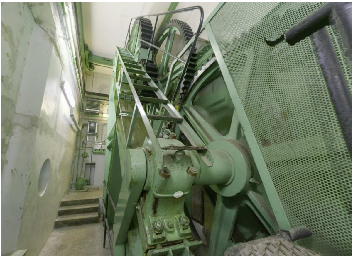
Figur 19: Klappille København, maskinrum syd, geargalleri. Tandhjulsudveksling der overfører de drejende kræfter til drivhjulet, der igen bevæger tandstangen. Foto.
