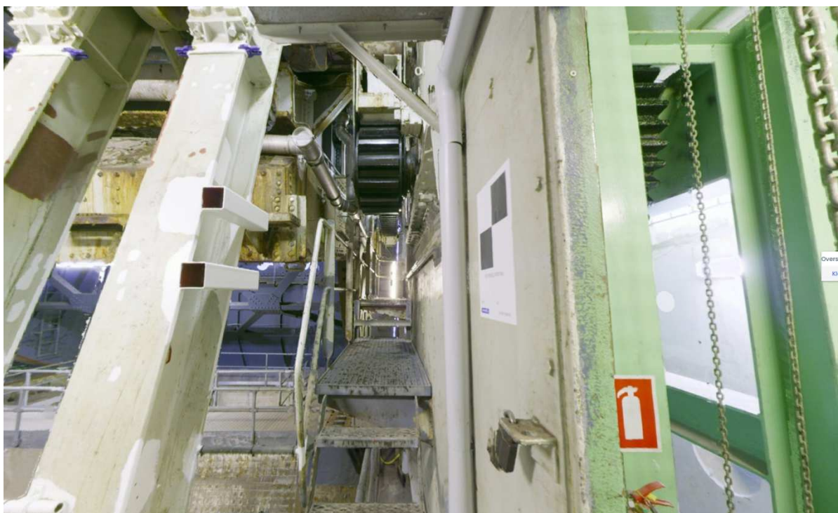
Figur 22: Klapkælder København, syd. Drivhjul og tandstang i klapkælderen. Til højre anes geargalleriet i maskinrum syd. Foto.
