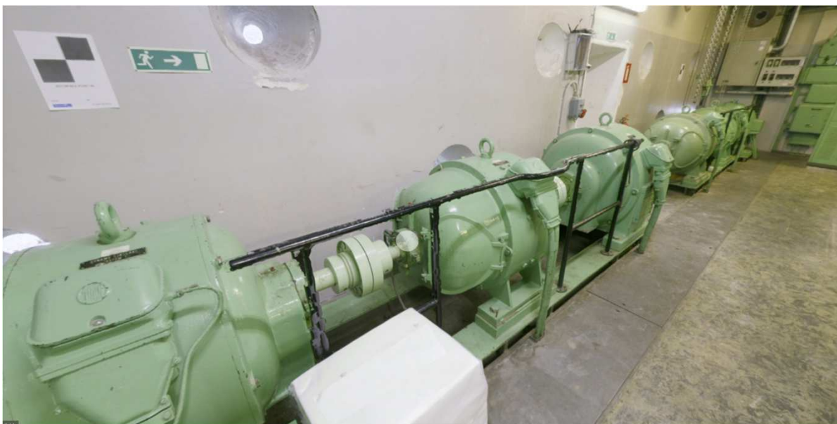
Figur 19: Overblikbillede over maskinrum Sjælland nord set fra vest. Alt maskineri og installationer der ses på billedet, bliver inaktivt, men bevares da det ikke er i vejen. Også her ses kabelkanal, der under låget ryddes for gamle kabler og giver plads til de nye.
