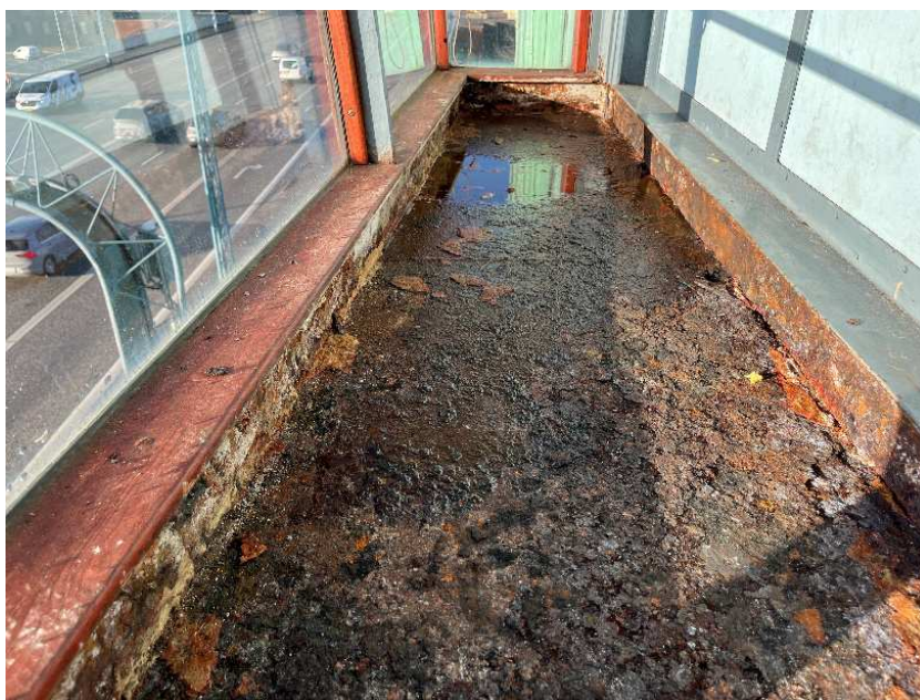
Figur 29: Rusten stålplade under gulv på kommandobroens balkon - efter optagning af gulvbelægning.
