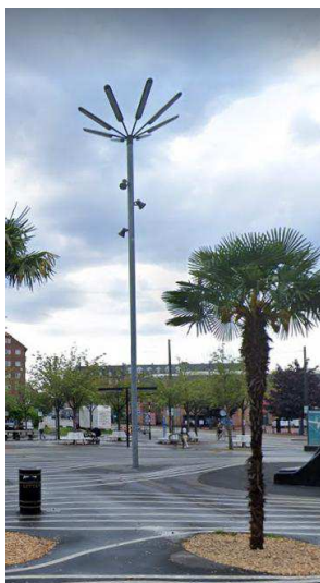
Lysstofrør på toppen af mast - Armatur: AMT Lysstofrør NRB 301 (8 stk. Lysstofrør på en mast, 135W pr. lyskilde). Bidrager også til grundbelysningen på selve pladsen. Spots på masten skiftes i almindelig vejgenopretnings regi
