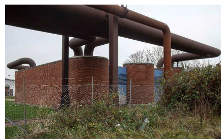
26. Teknisk anlæg ved Vasbygade.
