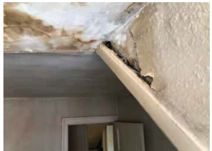
Loft med fugtskader og skimmelsvamp.
