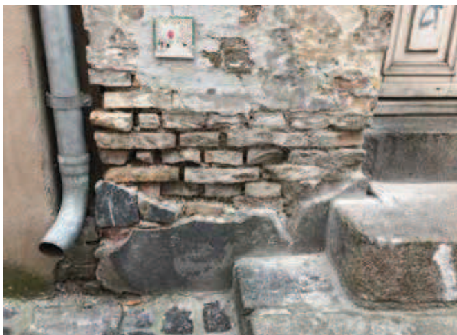
Udvendig vandskade på sokkel.
