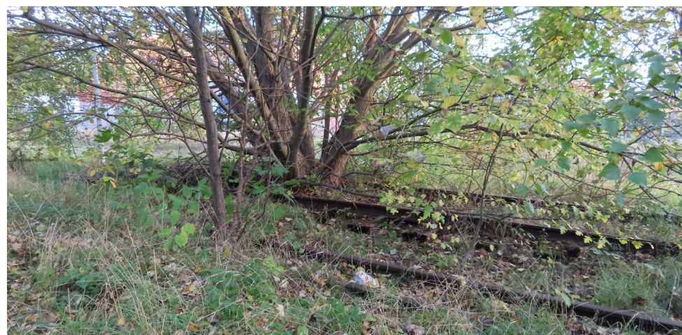
Enkelte steder i det vestligste stykke gør naturen sit for at kræve området tilbage. Her har et stort træ i det tosporede stykke løftet hele skinnestykket.
