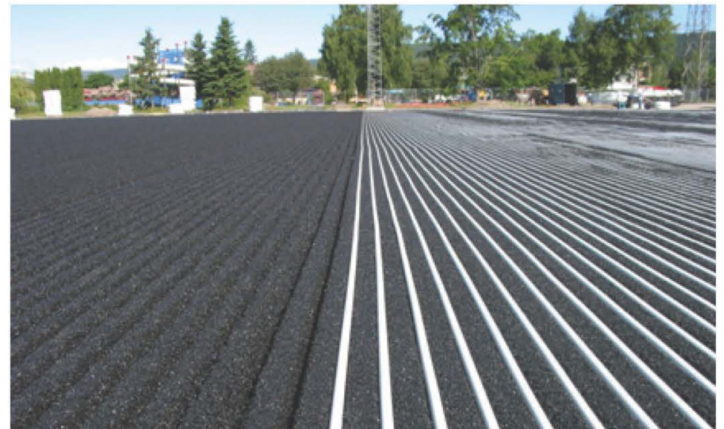
Figur 3: Rør i pad. NB! Billedet viser rør på tværs af en bane, men på Genforeningspladsen vil rørene følge kunstisbanen
