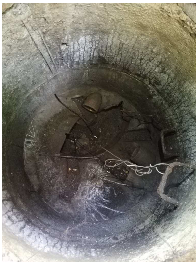
Billede 4. Brud i kloakbrønd
