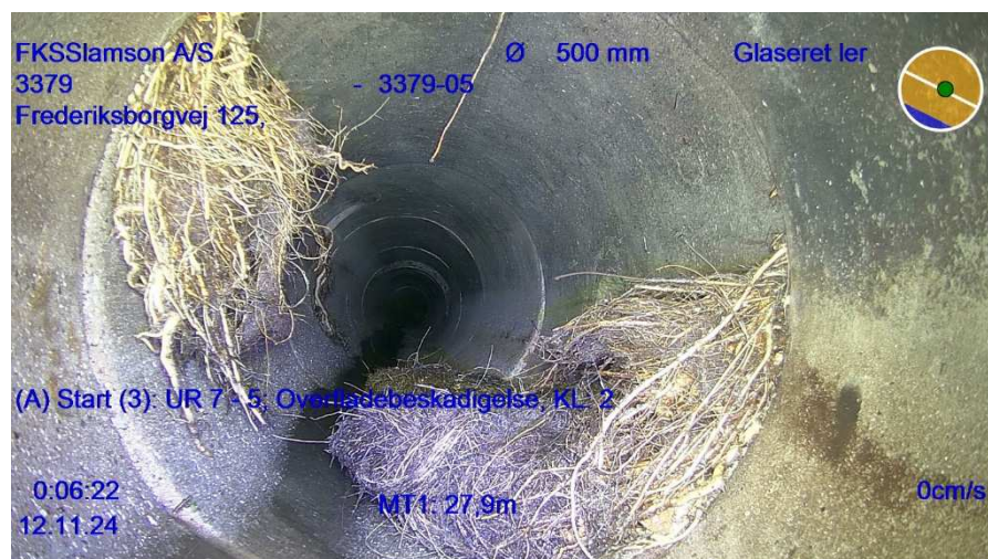
Billede 2. Kloakrør gennembrudt af træødder
