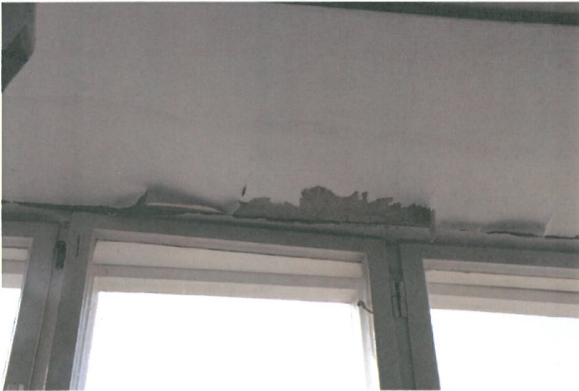
Billede 2. Fugtskade fra regnvejr i et andet klasselokale.
