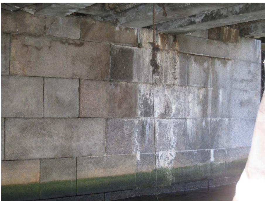
Gennemsvivninger ved vederlag og skader på betonkonstruktioner
