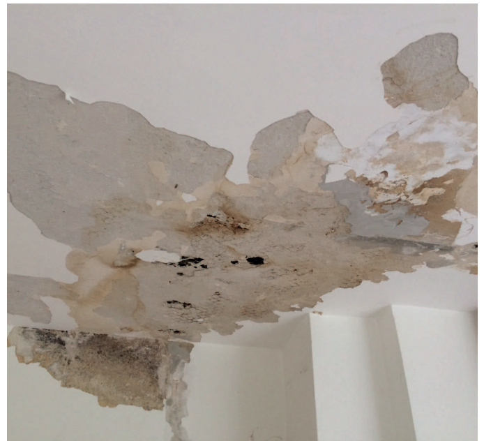
Tegn på fugt grundet uisoleret fladt tag
