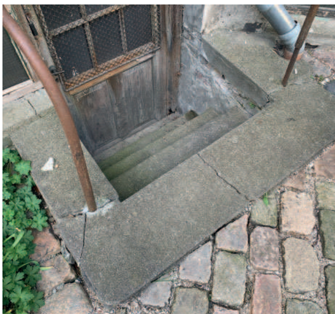
Kældertrapper og lyskasser skybrudssikres
