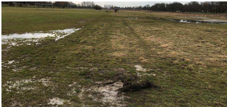
Figur 2.17: Foto efter spuling af drænedning fra sandfangsbrønd den 5. april 2018. I forgrunden ses et sandet område, hvor vandet under spulingen vældede relativt kraftigt op ad jorden.
