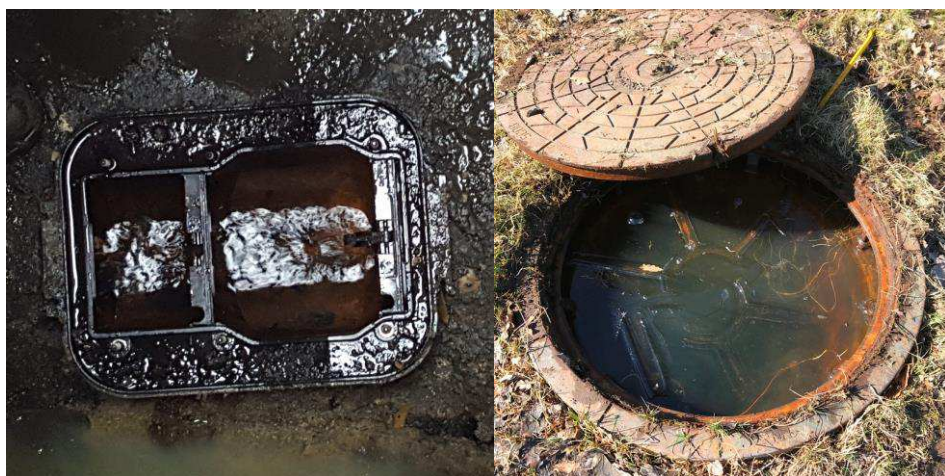
Figur 2.20: Th.: Højvandslukke efter dæksel er fjernet, tv.: brønd hvor højvandslukke er placeret. Brønden er utæt og grundvand trænger ind i brønden.
