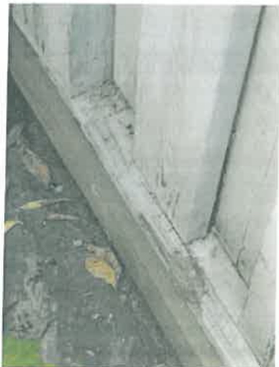
2. Fugt fra plankeværk/mangl. afdækning af kant
