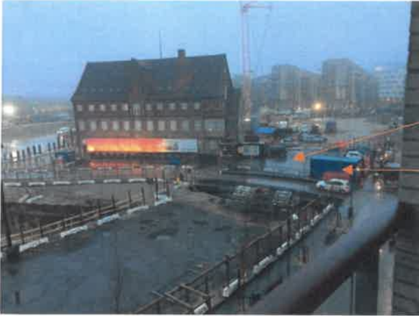
Foto 1. Den asfalterede parkeringsplads. Den blå Kontainer indeholder relikvier til ejendomsmæglerne
