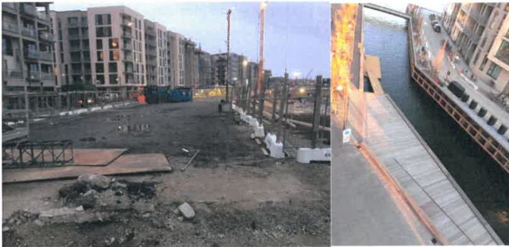
Foto 3 og 4: udsigten til hovedkanalen som affaldsplads og den udgravede kanal rundt om hjørnet.
