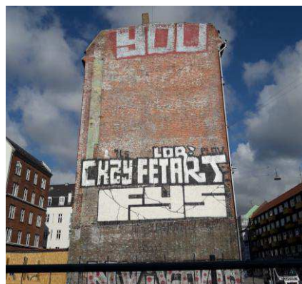
Billede fra stedet - Ikonisk gavl mod Svanevej 2. Byggearbejdet for 41 ungdomsboliger er netop begyndt.
