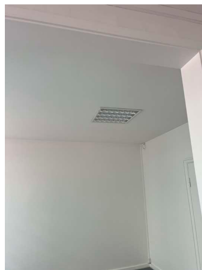
1. Sal Nedhængt loft med indbygget armatur
