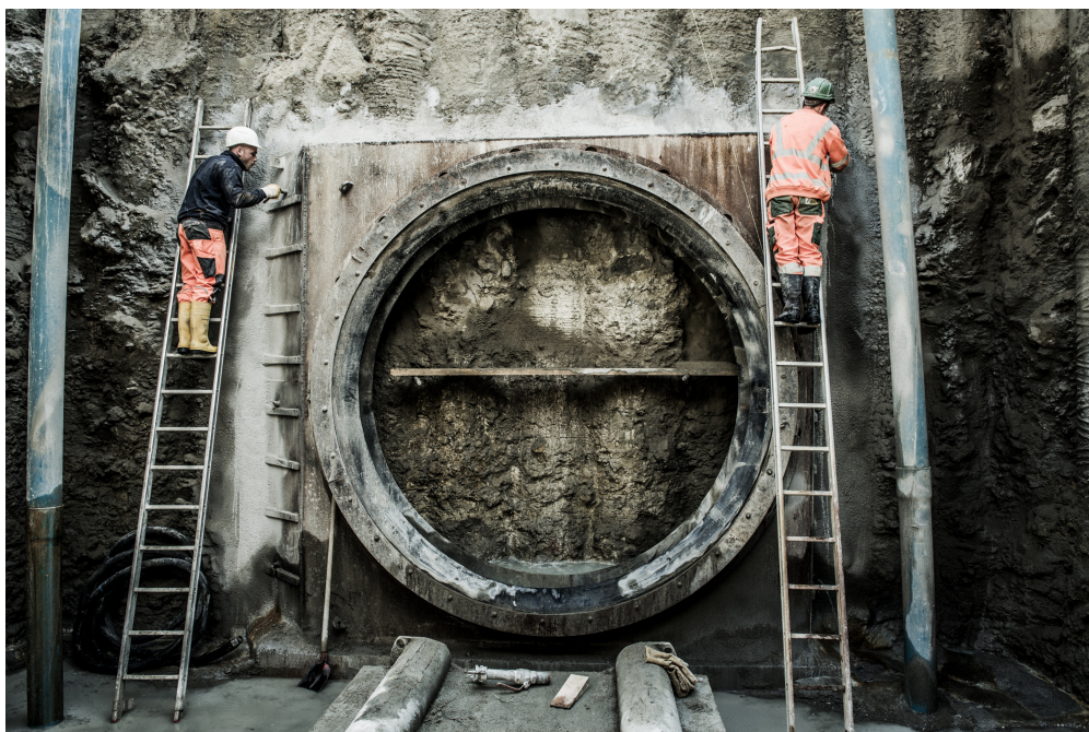
Damhusledningen - en bassinledning. Foto: HOFOR
