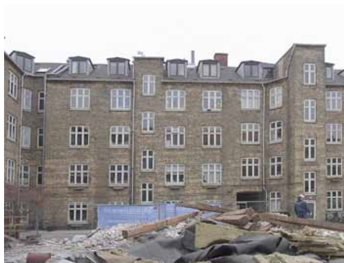
Facade mod gård. Gårdhaven er ved at blive anlagt. Værkstedbygningen er nedrevet.
