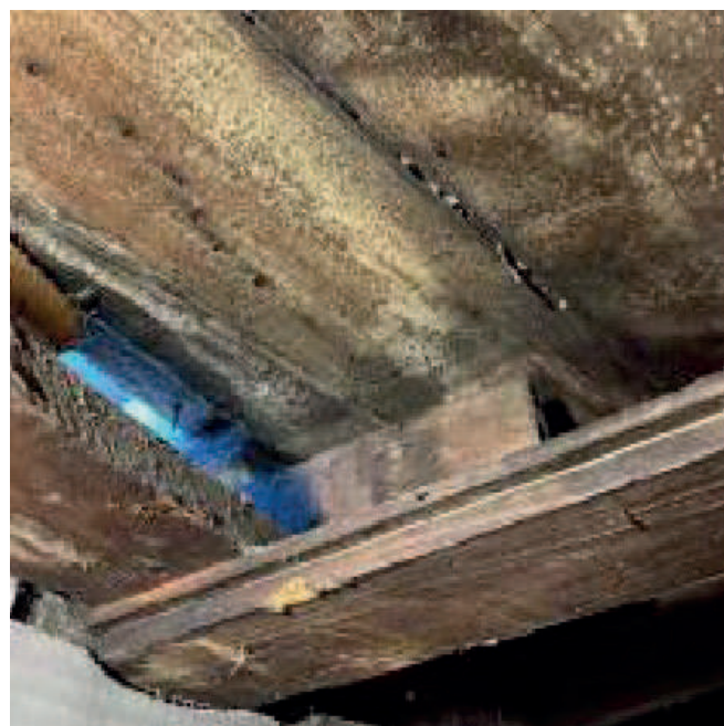
Kraftige fugtskjalder og skimmel på loft, som følge af utætheder
