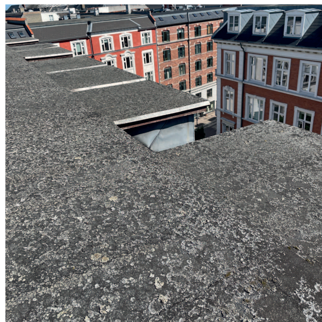
Taget er nedslidt og skal udskiftes
