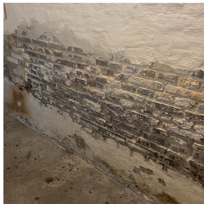
Fugtplagede vægge i kælder
