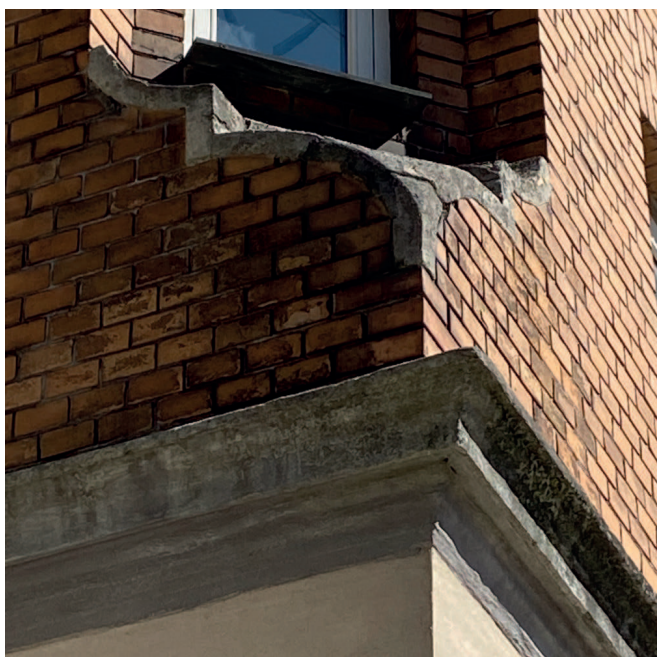
Facaden er væsentligt nedslidt
