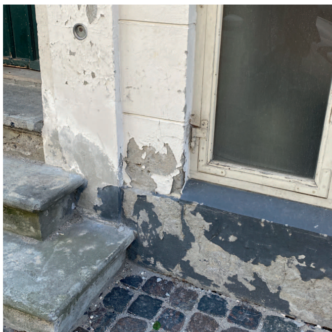
Facaden mod gade er meget nedslidt
