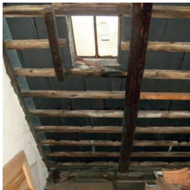
Taget er udskiftningsmodent med tegn på utætheder
