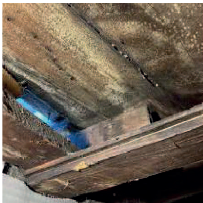
Kraftige fugtskjalder og skimmel på loft, som følge af utætheder MKB, BYGNINGSFORNYELSE
