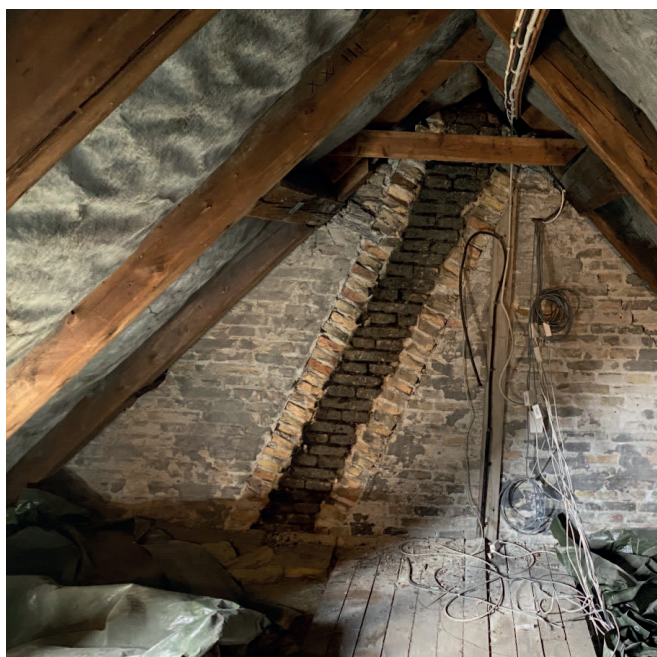
Spidsloft under utæt tag
