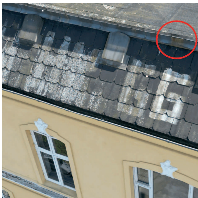
Slidt tagbeklædning i eternitskifer samt inddækninger udskiftes BYGNINGSFORNYELSER 2025
