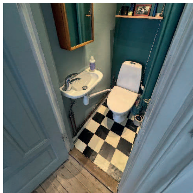
Der etableres bad i boliger, der mangler
