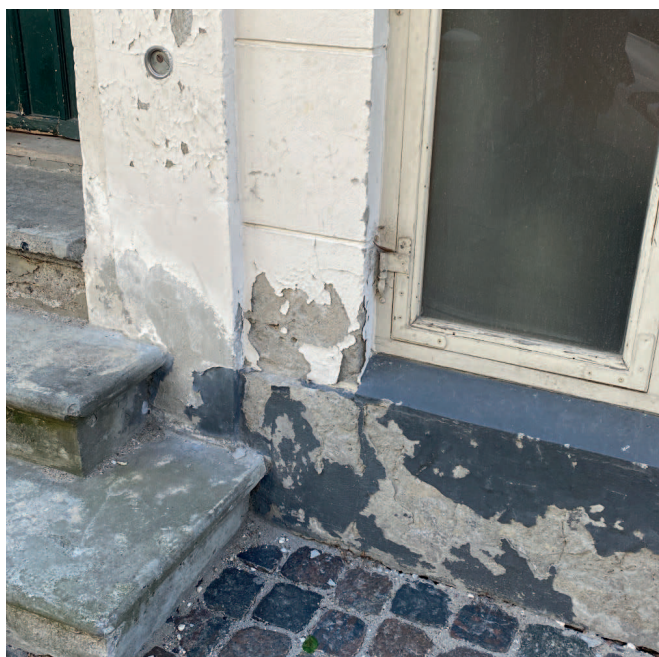
Facaden mod gade er meget nedslidt
