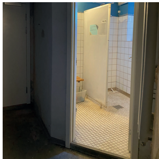
Fællesbad i kælderen til de beboere der mangler eget bad
