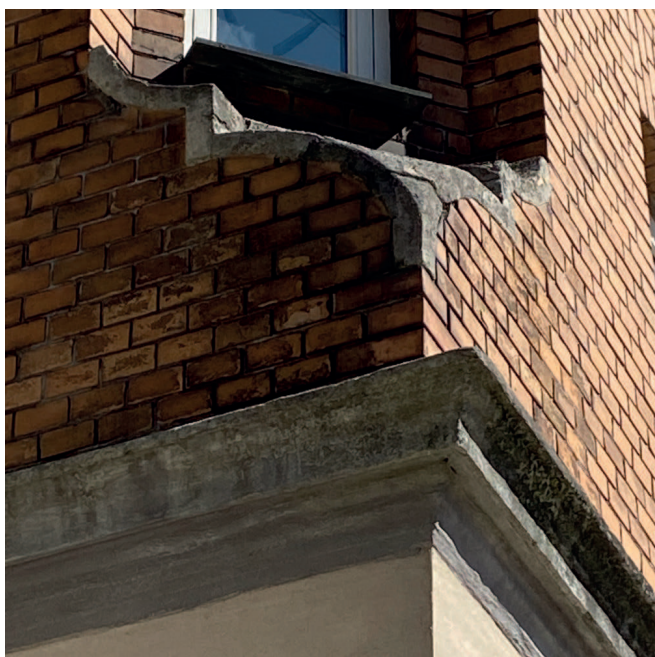
Facaden er væsentligt nedslidt
