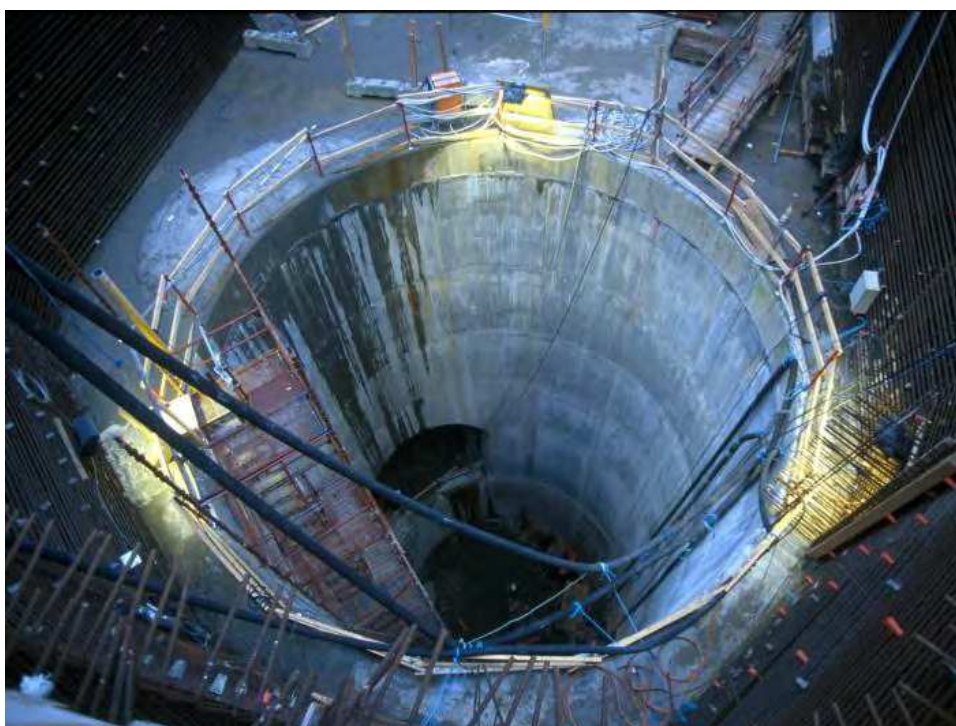
Figur 4.10 Skakt foret med beton på indersiden for opnåelse af jævn og tæt overflade, Københavns Metro.
