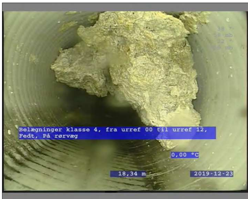
Foto: 2_13A, Medie #: TV2-414, 00:02:37 18,3m, Belægninger klasse 4, fra urref 00 til urref 12, Fedt, På rørvæg
