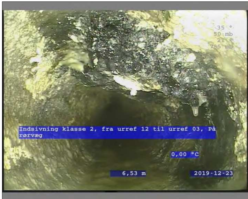
Foto: 7_9A, Medie #: TV2-414, 00:02:52 6,5m, Indsivning klasse 2, fra urref 12 til urref 03, På rørvæg
