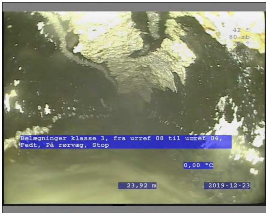
Foto: 6_19A, Medie #: TV2-414, 00:07:51 23,9m, Belægninger klasse 3, fra urref 08 til urref 04, Fedt, På rørvæg, Stop
