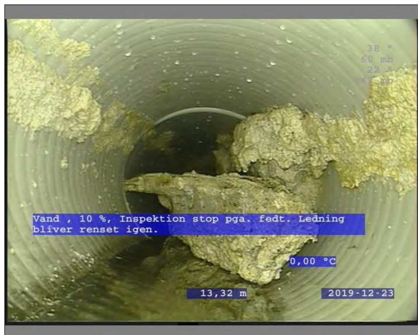
Foto: 1_6A, Medie #: TV2-414, 00:03:28 13,3m, Vand , 10 % / Inspektion stop pga. fedt. Ledning bliver rensset igen.
