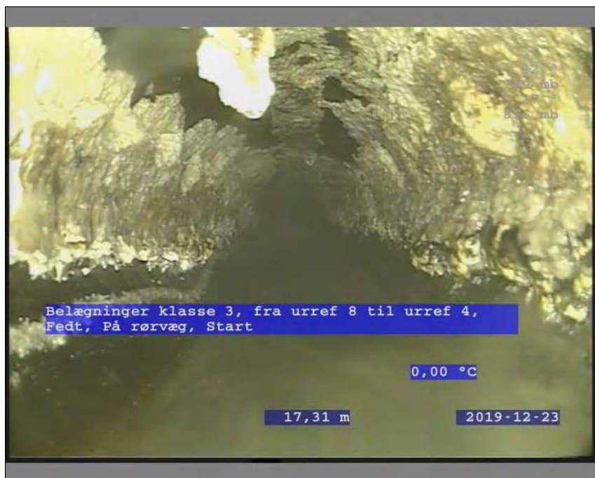
Foto: 6_16A, Medie #: TV2-414, 00:05:44 17,3m, Belægninger klasse 3, fra urref 8 til urref 4, Fedt, På rørvæg, Start
