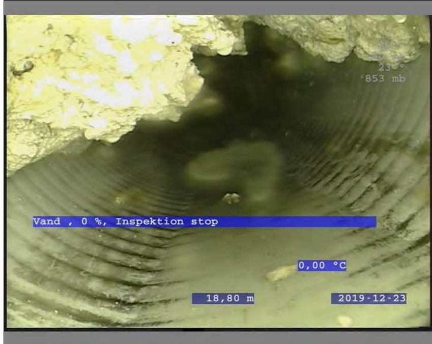
Foto: 2_16A, Medie #:: TV2-414, 00:04:32 18,8m, Vand , 0 % / Inspektion stop
