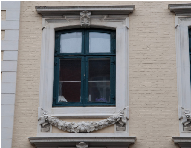
Foto 8. Flere huse i blankt murværk er blevet overmalede direkte på den blanke mur, så de nu fremstår som hverken pudsede eller i blank mur, som øvrige facader i området.
