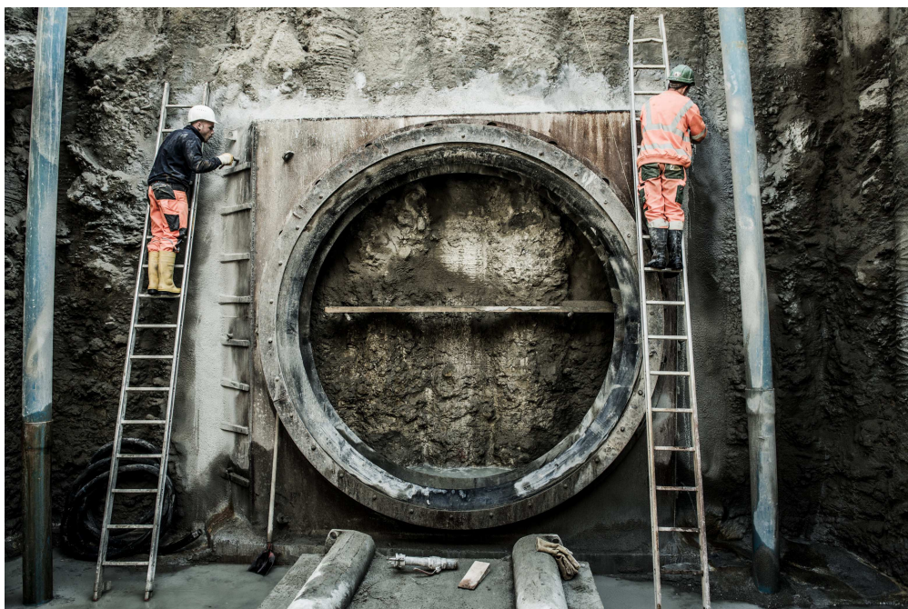
Damhusledningen - en bassinledning. Foto: HOFOR
