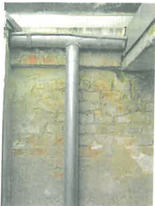
3. Bagfald/nedsivning af vand fra nabobygning ved gavl
