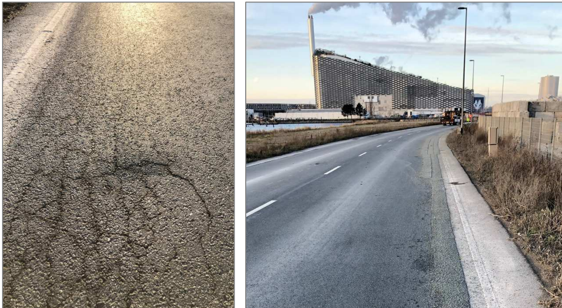
Figur 10. Revnedannelse samt reparationsarbejder på Jordtransportvej.
