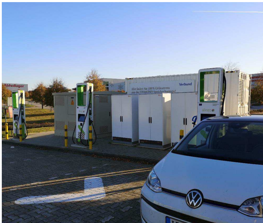
Figur 15: Eksempel på en ladehub med batteri-backup (placeret decentralt i containeren bagved teknikskabene). Fra Allego's ladehub i Kaltenkirchen, Tyskland
