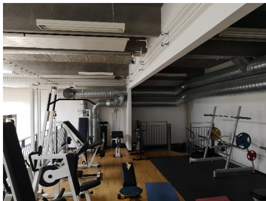
Hal 1 med indskudt etagedæk hvorpå der er placeret kondi maskiner.
