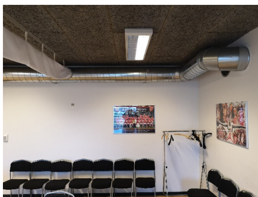
Hal 2. Ventilationsanlæg med indblæsningsposer.
