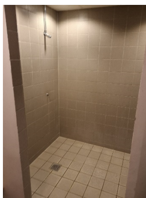
Bruserum har kalklag på klinkerne.
