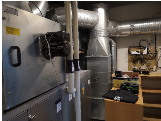
Stort ventilationsanlæg i Hal 1
