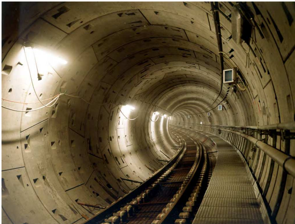
Figur 4.4 Færdigmonteret tunnelrør med spor, nødfortov, kørestrøm og andre mekaniske og elektriske installationer.
