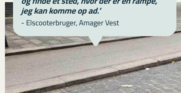
Manglende ramper fra fortov til cykelsti og vejbane ved busstoppested "Ørestad St. (Ørestads Boulevard)", Amager Vest.
