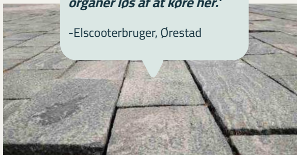
Eksempler på ujævn belægning ved Ørestad Blvd., Amager Vest.
