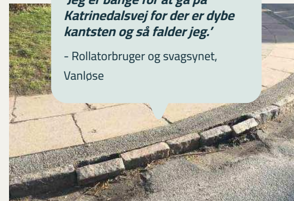
Løse kantsten på hjørnet af Bangsbovej og Knivholtvej, Vanløse.
