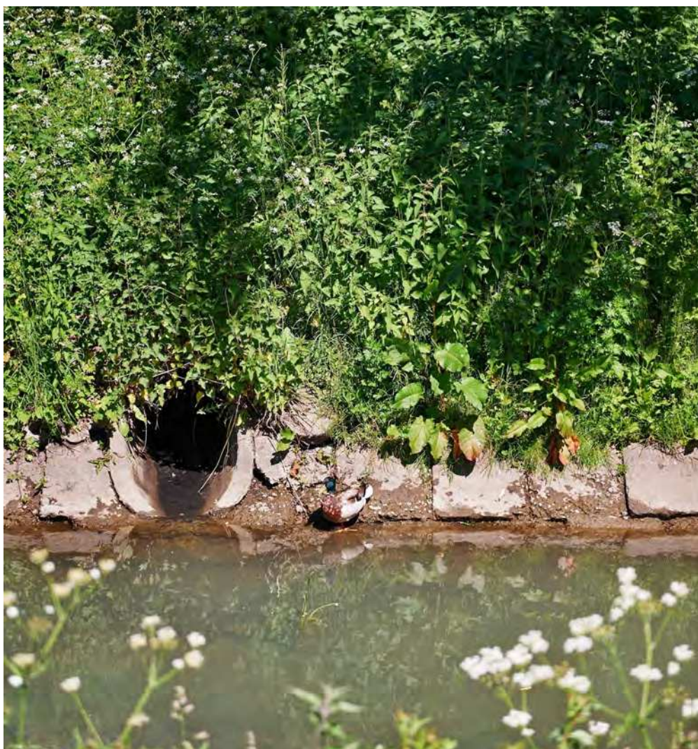
Regnvandsudløb ved Harrestup Å. Foto: HOFOR
