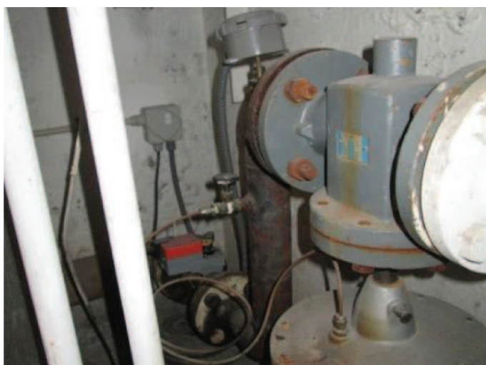
Uisolerede rør i varmeanlæg
