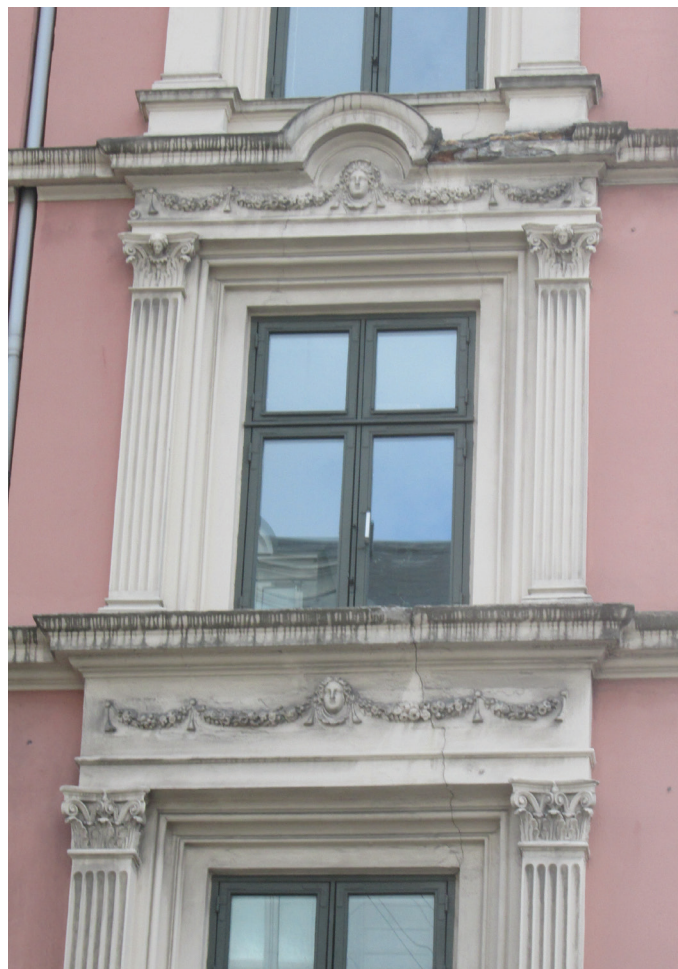
Facadeudsnit af nedbrudte gesimser og udsmykninger
