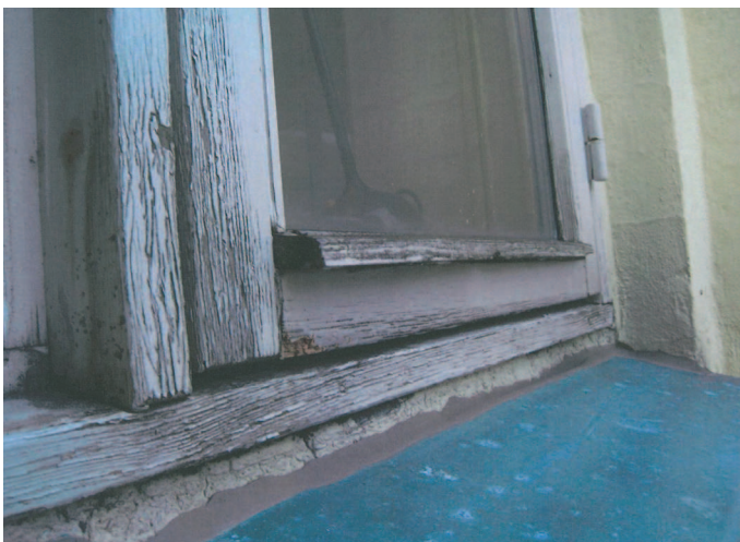
Råd i vindue og utætte fuger
