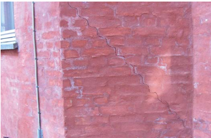
Sætningsrevne (musetrappe) i gårdfacade
