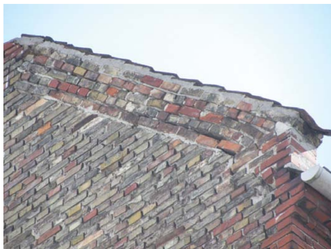
Nedbrudt bramdkam på baghusets vestgavl
