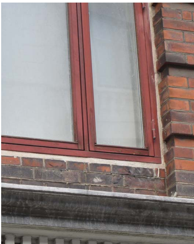
Ældre udtjent termovindue
