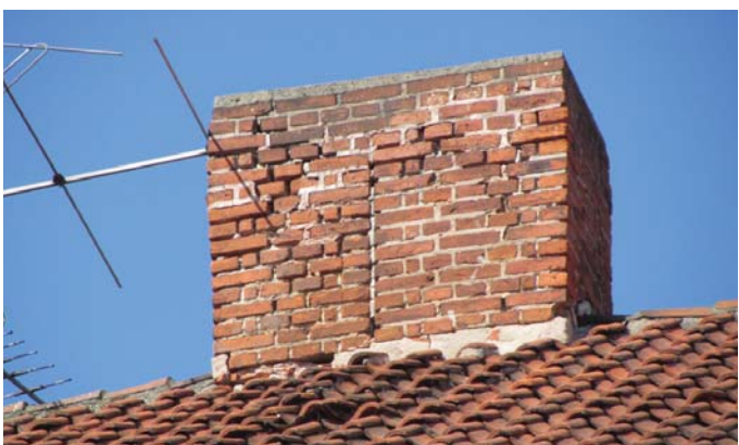
Nedbrudt skorsten og tagbelægning
