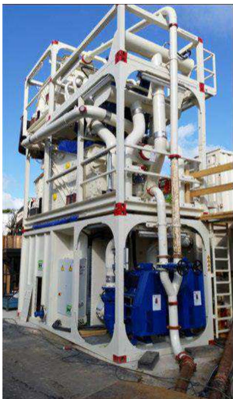
Figur 4-9 Separationsanlæg til slurry fra tunnelboremaskinen (uden afskærmning)
