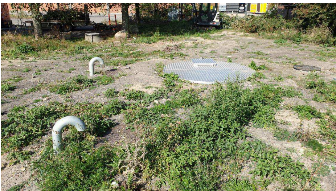
Figur 7-17 Referencebillede fra Rønne Havn af nyetablerede udluftningskanaler og dæksel
