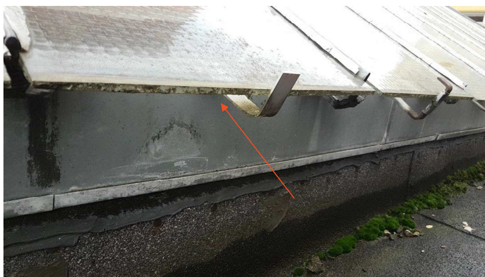
Figur 5 Samling ved ovenlys vindue, hvor der blev observeret utætheder. Rød pil markeret utæthed mellem glas og samling.
