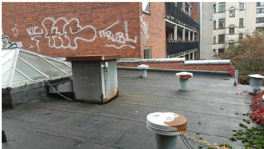
Figur 6 Foto der viser placering af spjæld og afkast på den sydlige del af taget.
