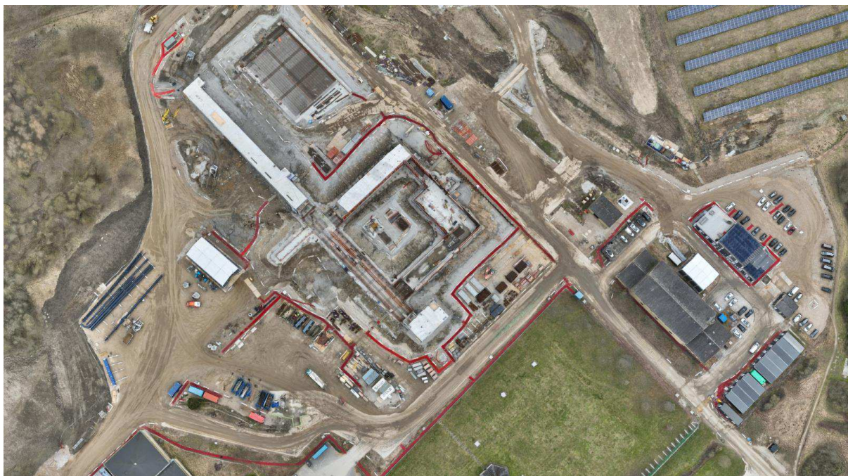
Figur 2. Opførelsen pågår. Der er lagt fundament på kældergange, og der arbejdes nu over terræn.
