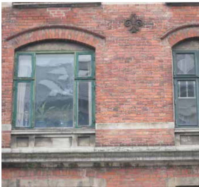
Vinduer og facade er væsentligt nedslidte
