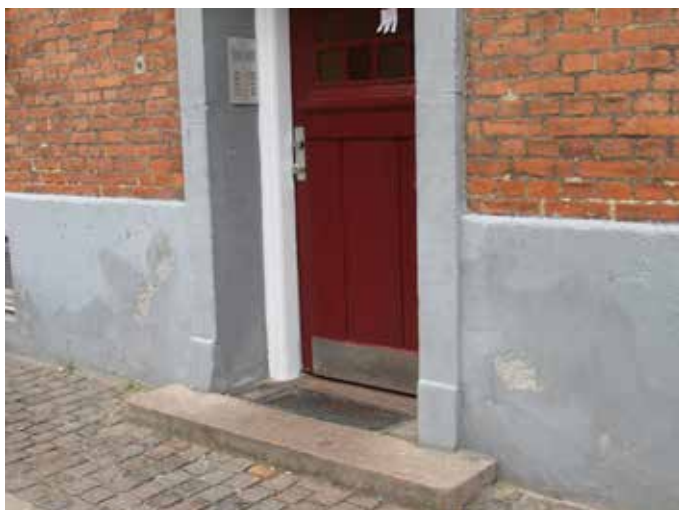
Synlig opfugtning af facade afhjælpes ved omfangsdræn
