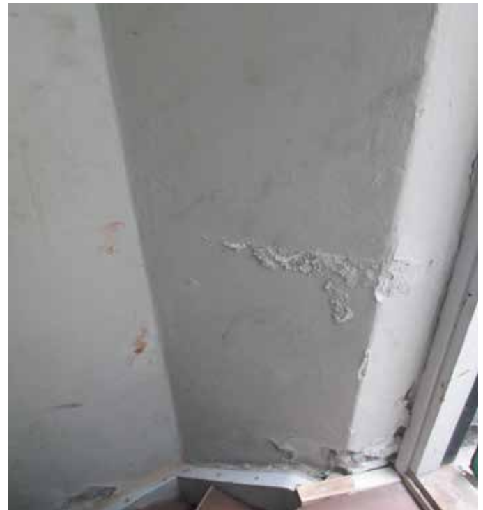
Synlige tegn på opfugtning af kældernedgange
