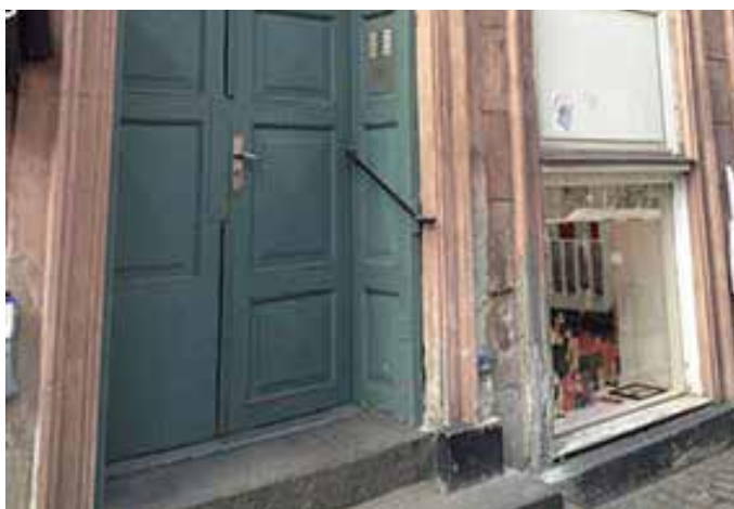
Tydelige spor efter fugt. Der etableres omfangsdræn
