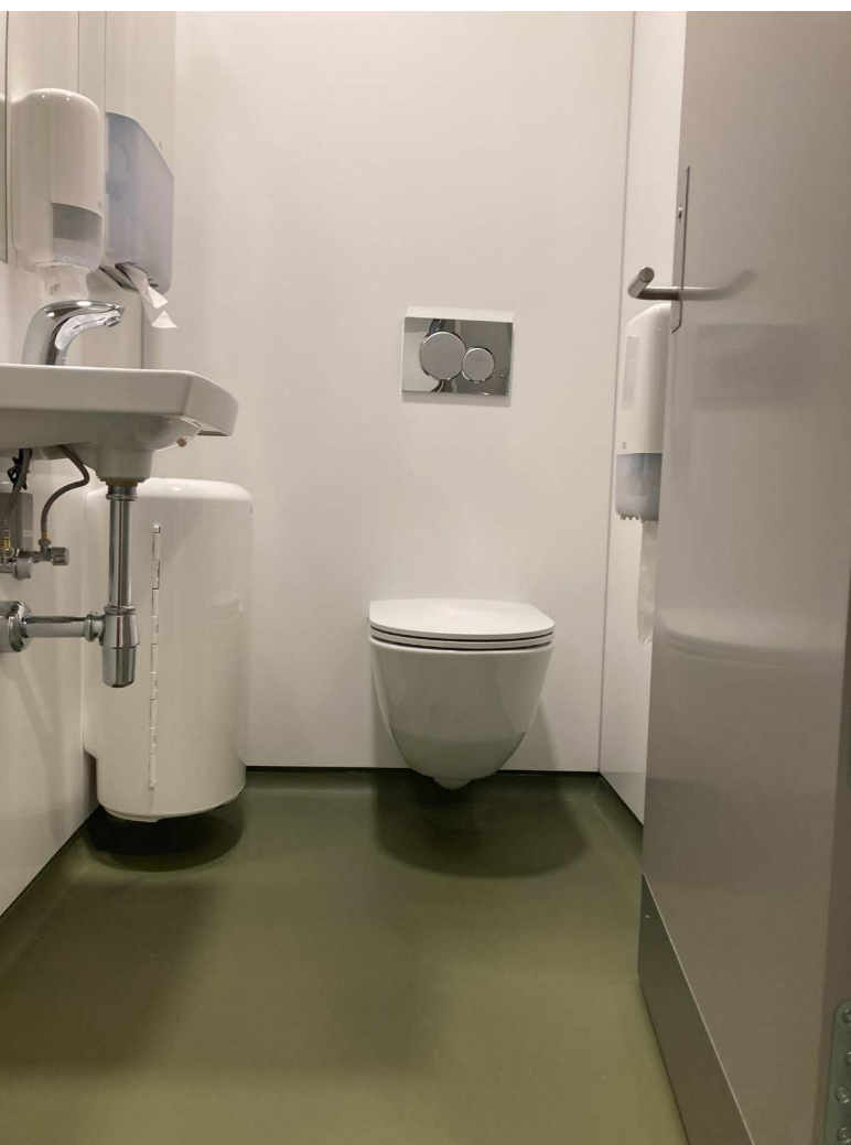
Gulvbelægning med afsluttet gulv med hulkele. Toilettet og øvrigt inventar er væghængt for også at lette rengøringen
