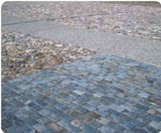
Belægning Vægtes mellem/lavt
