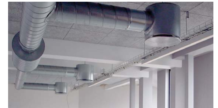
Synlig ventilation og akustikdæmpning i loftet
